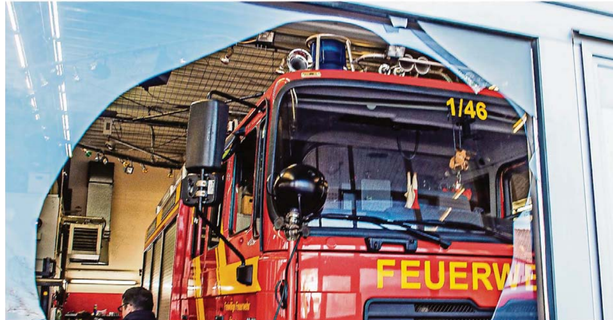
Der Täter zerdepperte die Glastür vom Feuerwehrhaus und kam so an die Fahrzeuge ran.
